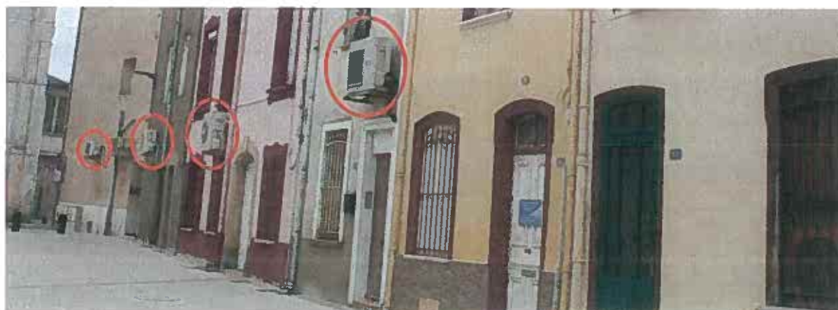
Contre-exemple : installations de climatiseurs non conformes
